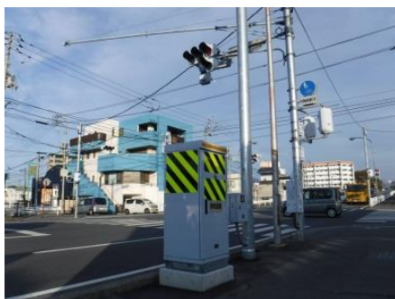
自動起動式発動発電機
